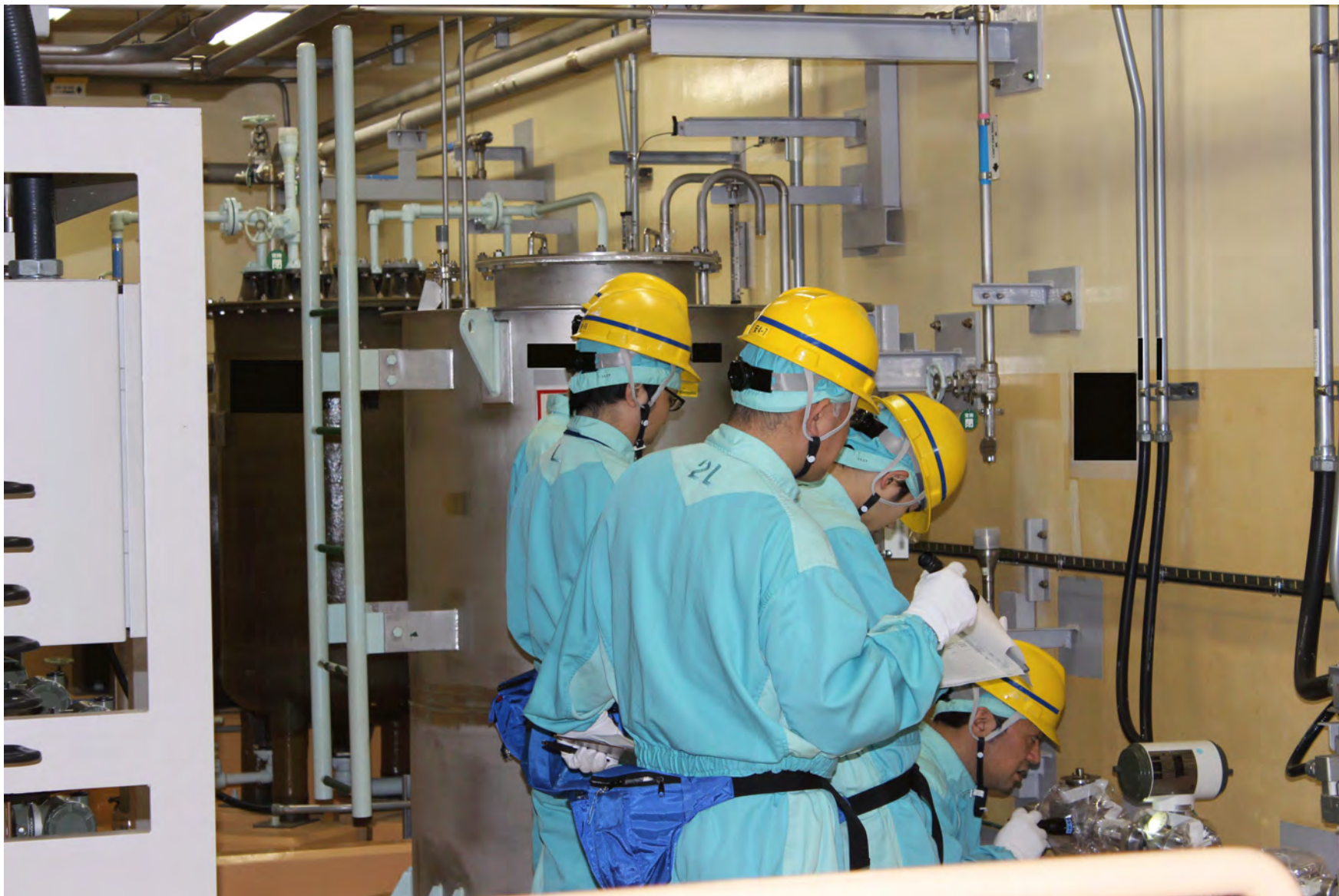
機器類を冷却する設備の確認
