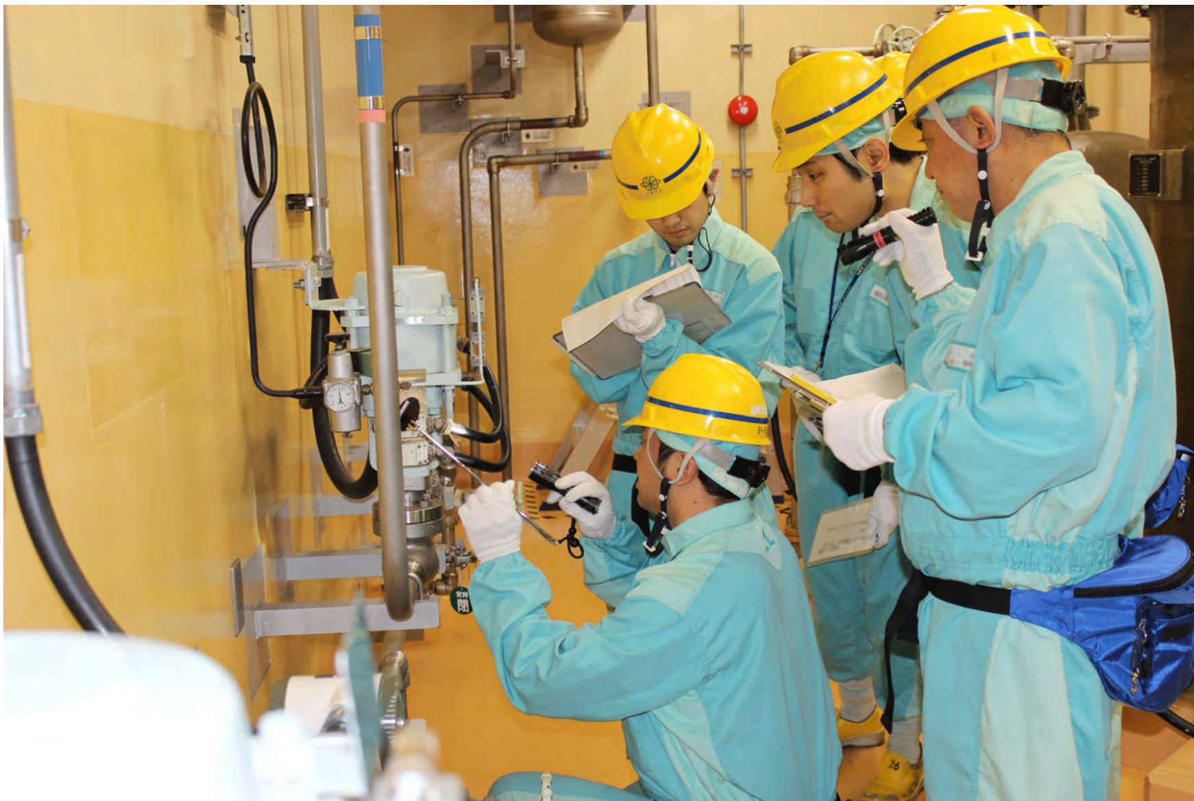
機器類を冷却する設備の確認
