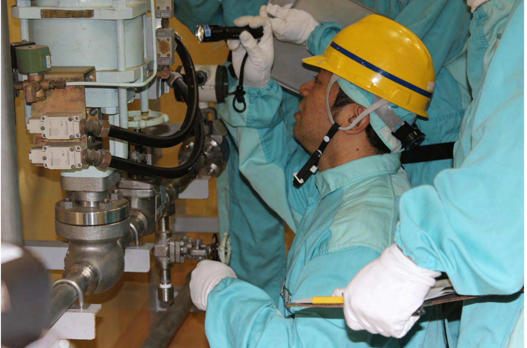
機器類を冷却する設備の確認
